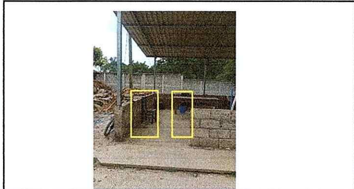
Foto 2: PUERTAS PARA COCINA
